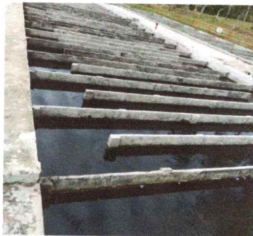
Fotografía 7. Floculador hidráulico de flujo Horizontal.
