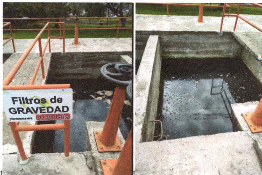
Fotografía 10. Sistema de filtrado.
